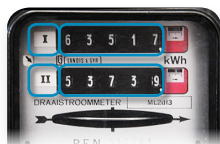
Twee telwerken boven elkaar
